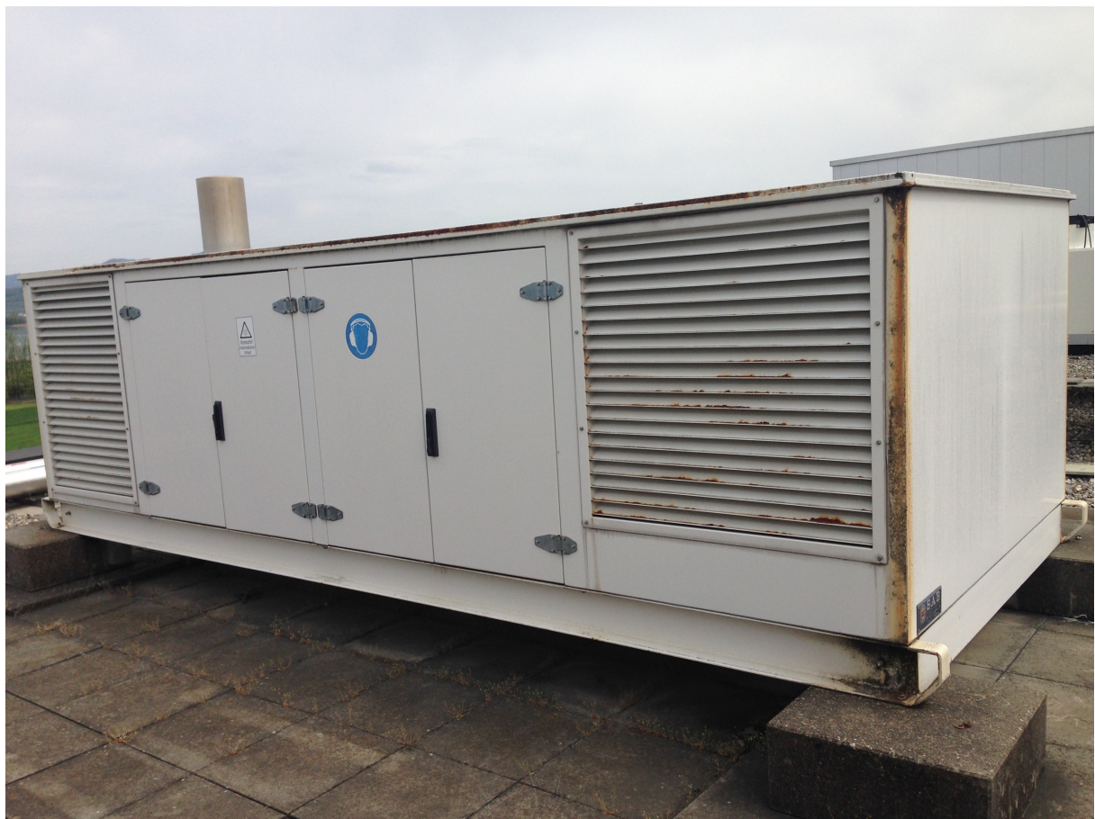
Genset 200 kVA, Super- Schallgedämpft 5200 x 2000 x 2500 mm Gewicht ! 5000 kg
