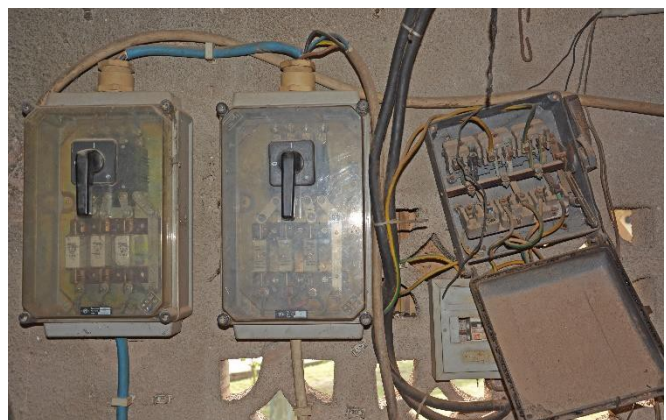
Elektroverteilung, die das ganze Spital versorgt
