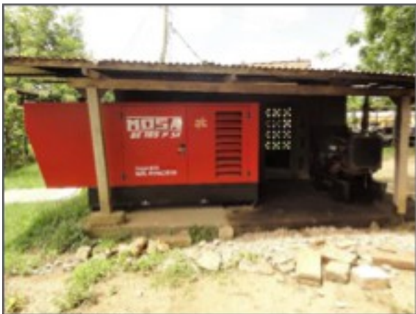
Der neue Comboni Genset installiert durch GSHT.
