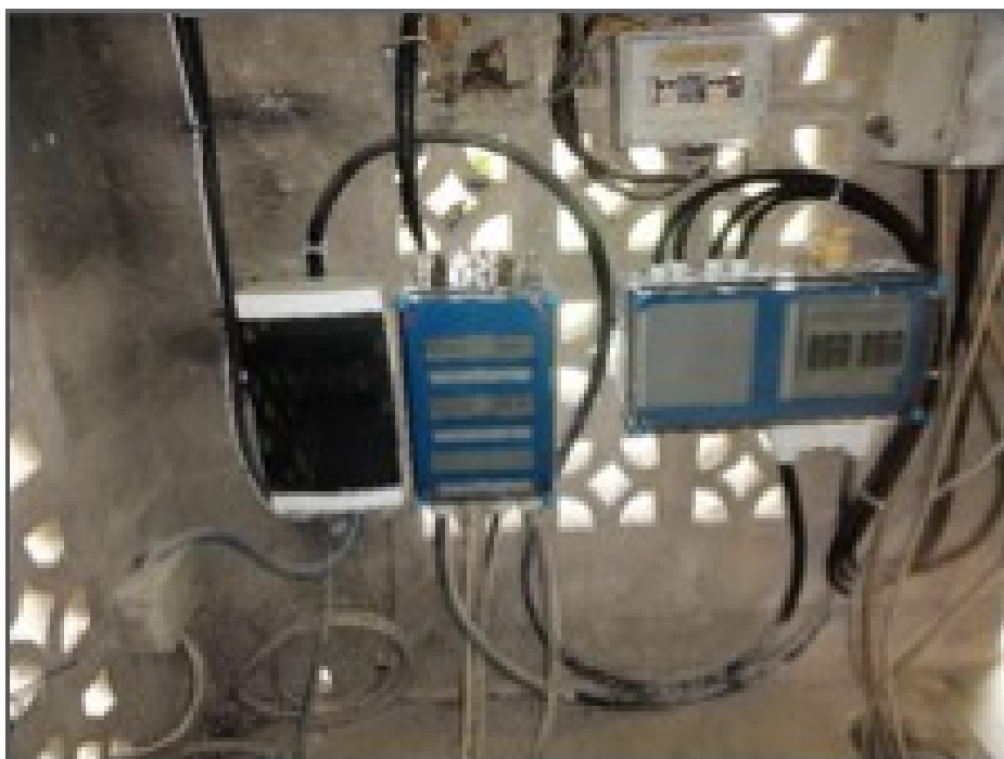
Provisorische Elektro- Hauptverteilung
